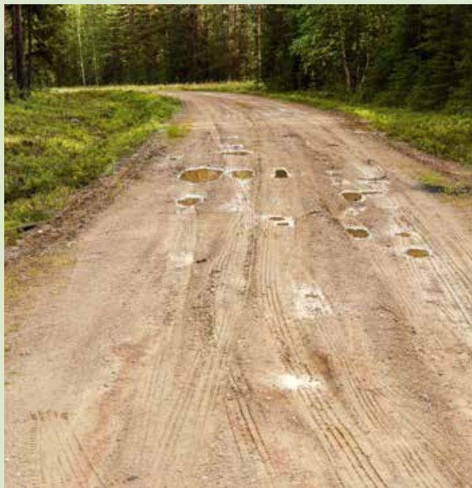
Ett svagt vägparti kan begränsa framkomligheten och göra att det inte går att avverka under barmark. Här kan det vara en god affär att öka bärigheten genom att lägga på kraftigare material och rensa diken.
