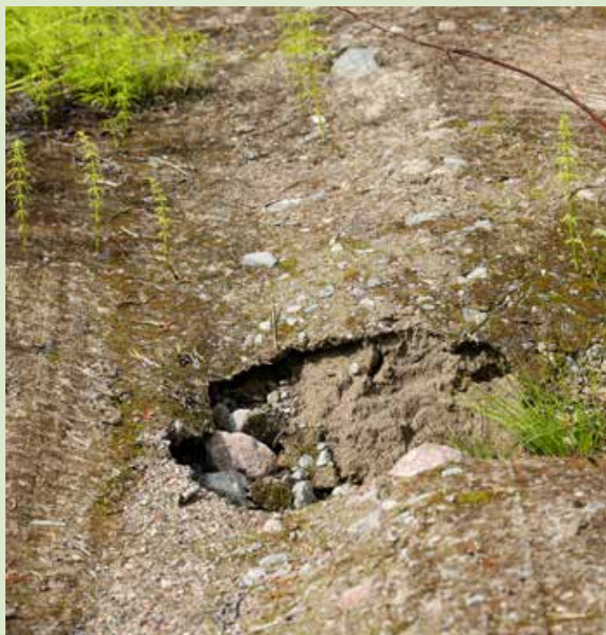
Om en vägtrumma har gått sönder är det viktigt att byta ut den så fort som möjligt. Annars kan det snabbt bli stora skador på vägen.
