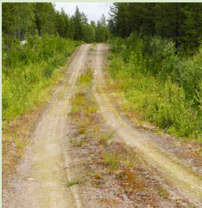
Här har dikena växt igen och växtligheten börjar leta sig in i vägbanan. Det behövs både hyvling och buskröjning för att vägen ska hålla sig torr och hållbar på sikt.
