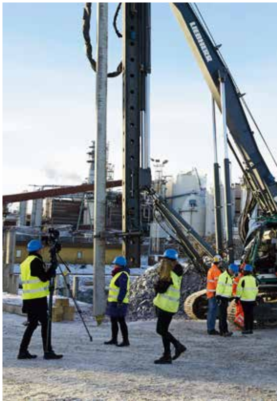
Östrandprojektet invigdes februari 2016 med att en 12 meter lång betongpåle slogs ner i marken.
