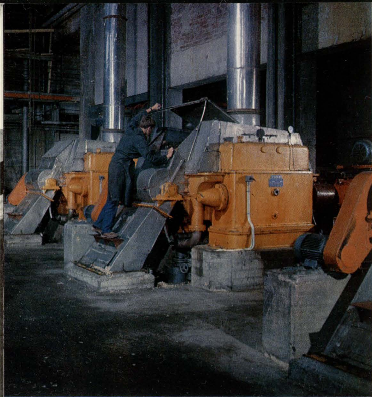
Detaljbild av SUND-IMPCO valspressar för höggradig av- vattning (SCA Obbola Sulfatfabrik, Obbola).
